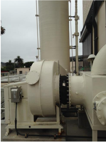
Odor Control Fan
