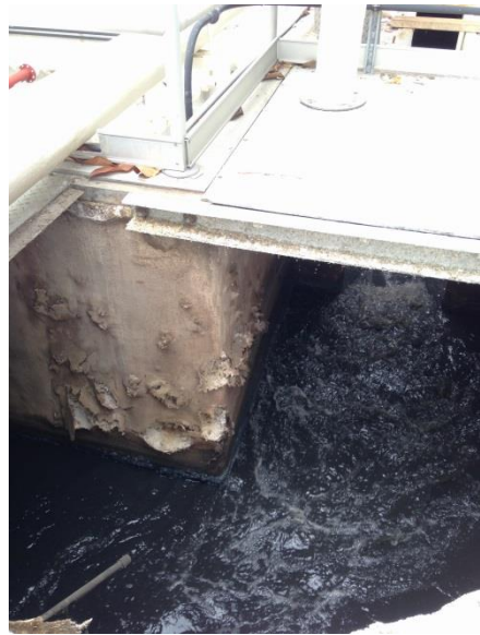
Grit Effluent Channel
