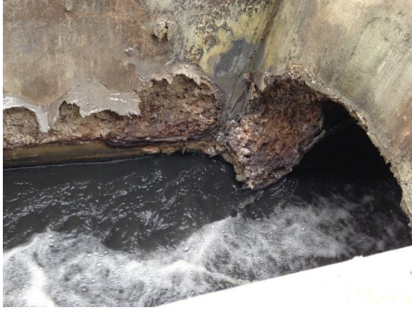
Grit Effluent Channel
