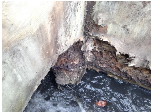
Grit Effluent Channel
